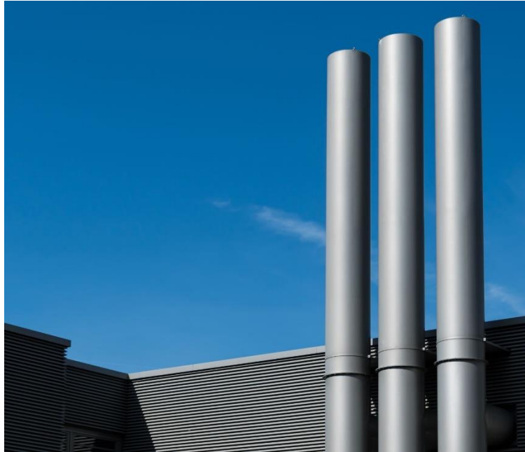
公私場所固定污染源排放管道
