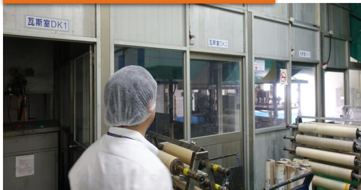
燃燒機作業區(燃料：天然氣)
