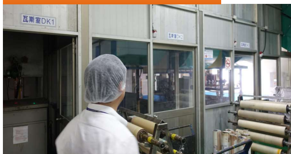
燃燒機作業區(燃料：天然氣)
